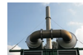
⑦ Consolidation 1/6, Gelsenkirchen Consol-Gas Anzahl Module: 1 x 1.36 kW
